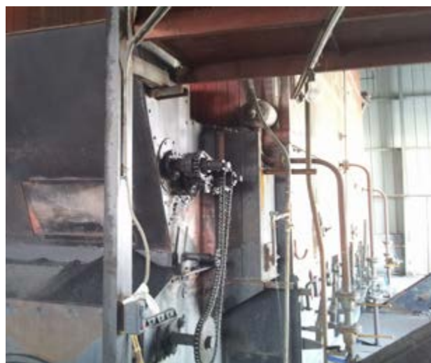
▲ 锅炉分行分层节能给煤装置
