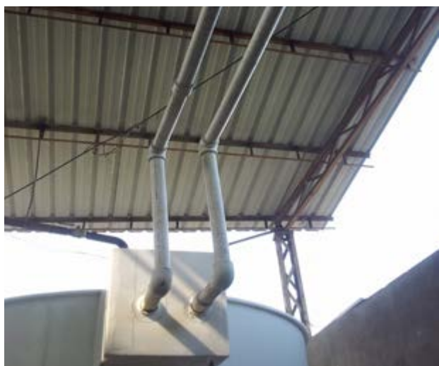
▲ 车间整烫蒸汽余热回收利用管道
